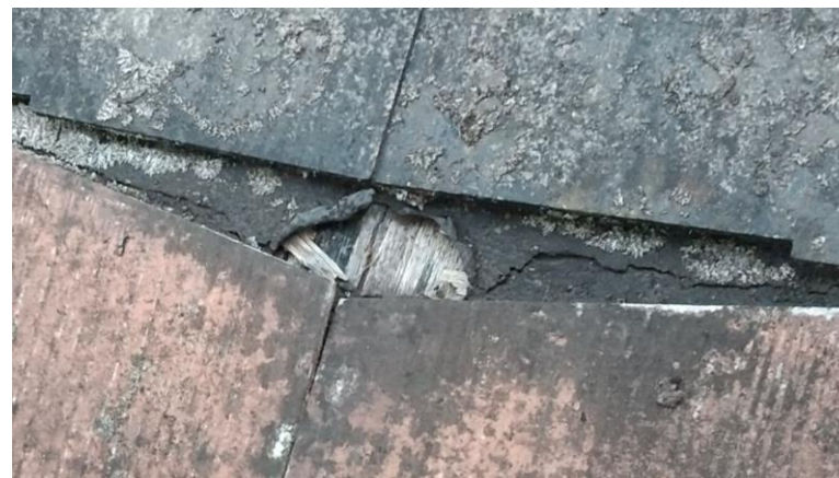
屋根材の下で安い防水シートが劣化し、防水シートが裂け、防水シートを張った木下地が剥き出しになっています
